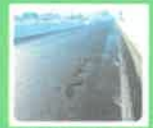
路面の穴ぼこ・段差
