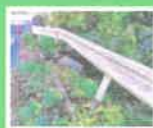
ガードレール・柵等の損傷
